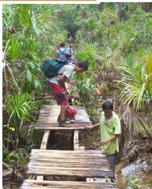
Puente deteriorado en madera (Vaupés)
